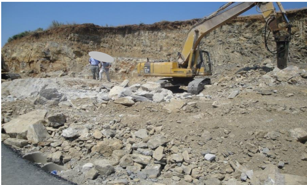
Figura 51 Dëmtim i ambientit dhe rrezikim i shkallëve përfundimtare si shfrytëzim pa kriter – MMPH
